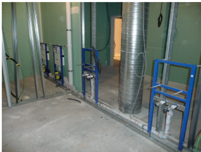
◀ Vor der Wand sind Geberit-Systeme installiert.
