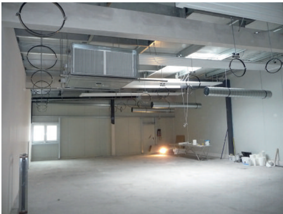
◀ Kampmann und Lindab lieferten die Komponenten für die Lüftungsanlage.
